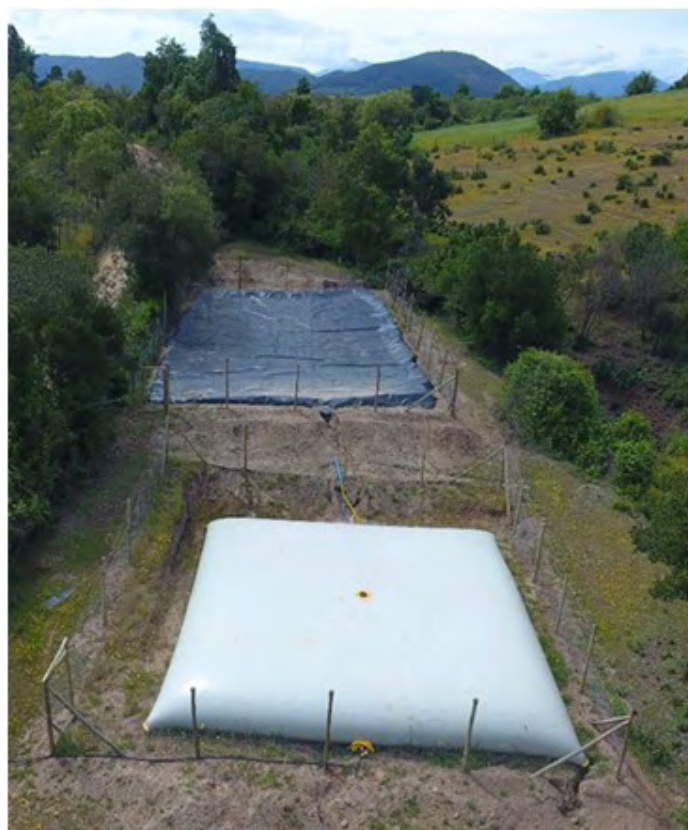
Figura 4. Sistema de Captación de Aguas Lluvias instalado en la Región del Maule (sector Rincón de los Muñoces, Región del Maule), con área de captación de geomembrana y estanque flexible de 80 m 3
