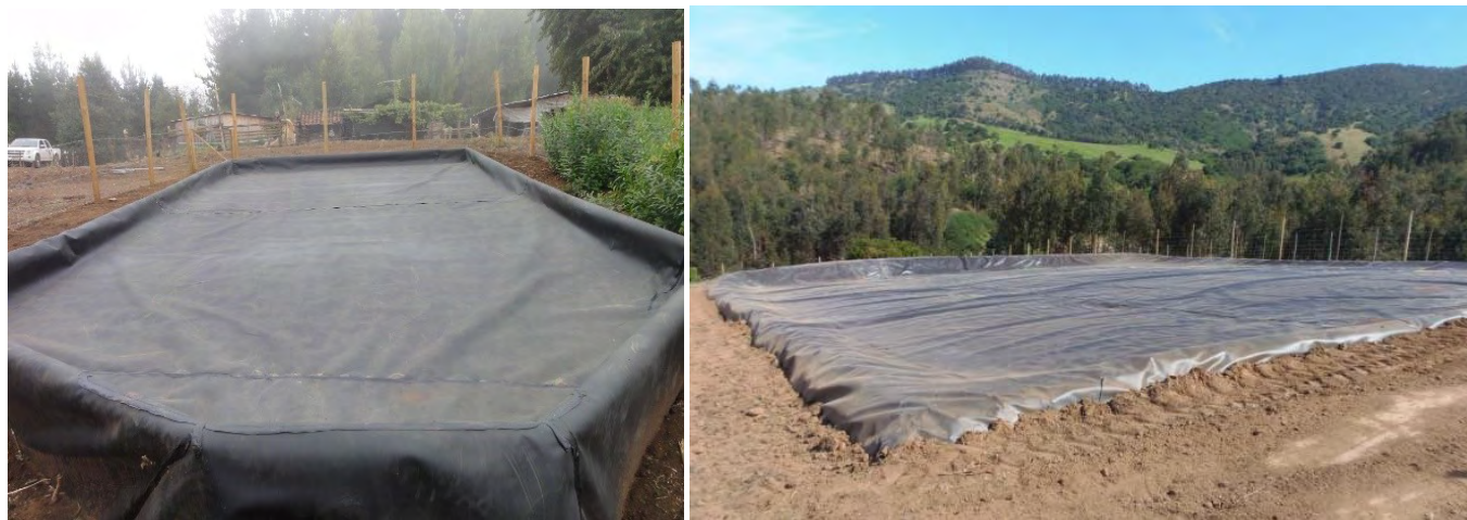
Figura 2. Anclaje de la geomembrana: enterrada en una zanja perimetral (izquierda) y armazón de polines (derecha)
