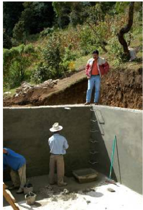
Cisternas de almacenamiento de agua comunitarias
