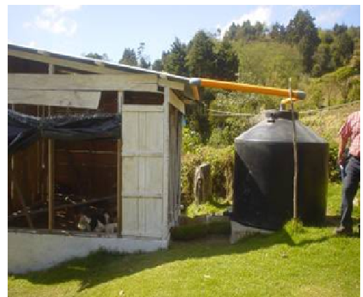
Sistema de captación del agua y tanque de almacenamiento
