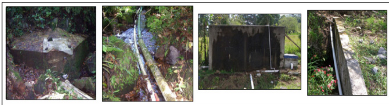
Figura 2. Principales estructuras del acueducto de Buenos Aires. De izquierda a derecha: obra de captación del manantial, tubos madre, tanque de almacenamiento y red domiciliaria
