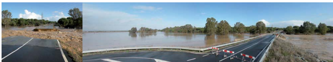
Figura 8. Corte del camino asfaltado entre El Rocío y Villamanrique por la corriente de la avenida del 4-01-2010 en la sección donde se situaba el paso de fauna, en el margen izquierdo del arroyo de la Cañada del Pinar, al este del Dique 2 y muy próximo a su ubicación. Izquierda: Detalle del corte del camino asfaltado. Derecha: Panorámica de la situación.
