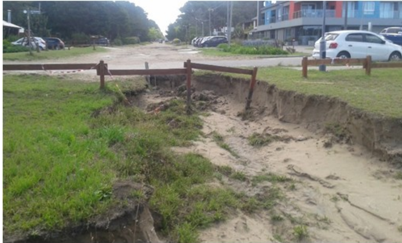
Figura 7. Erosión por descarga directa desde calzada con pendiente hacia el litoral. Pérdida de recarga del acuífero
