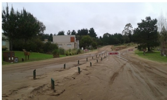
Figura 20. Estado de la calzada y el badén al 8h de finalizada la precipitación
