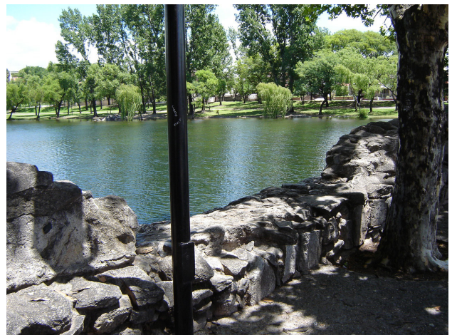
Figura 5: Zona del muro principal con el recrecimiento destruido.
